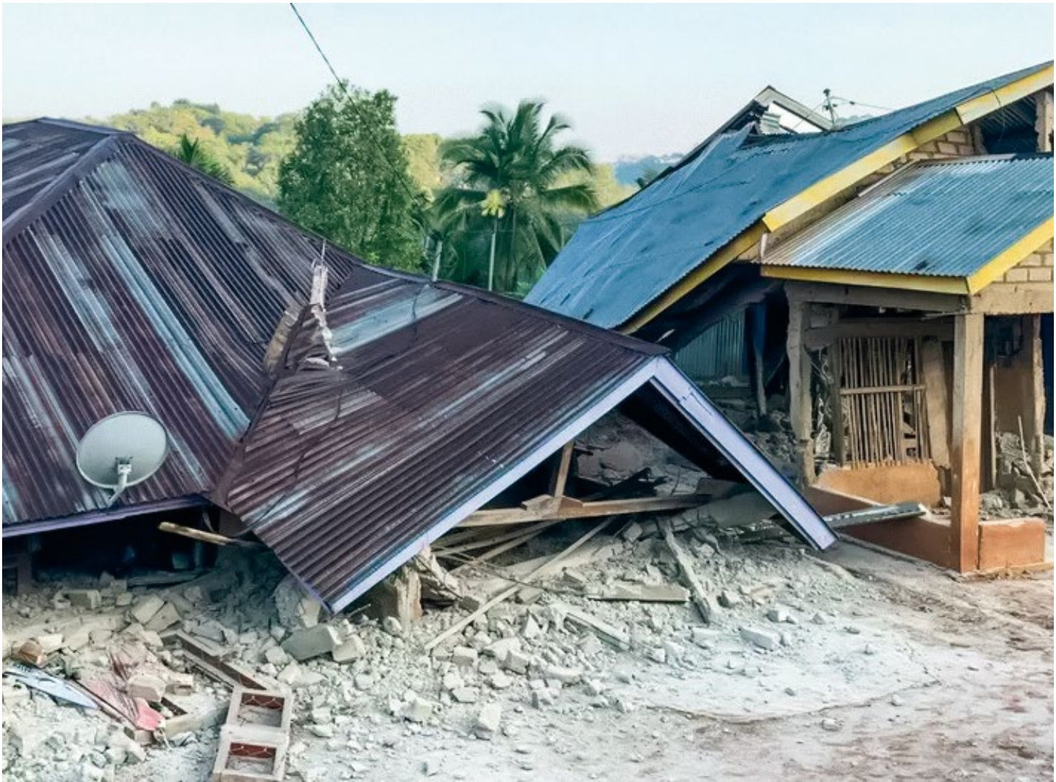
MUCHOS DAÑOS MATERIALES.
