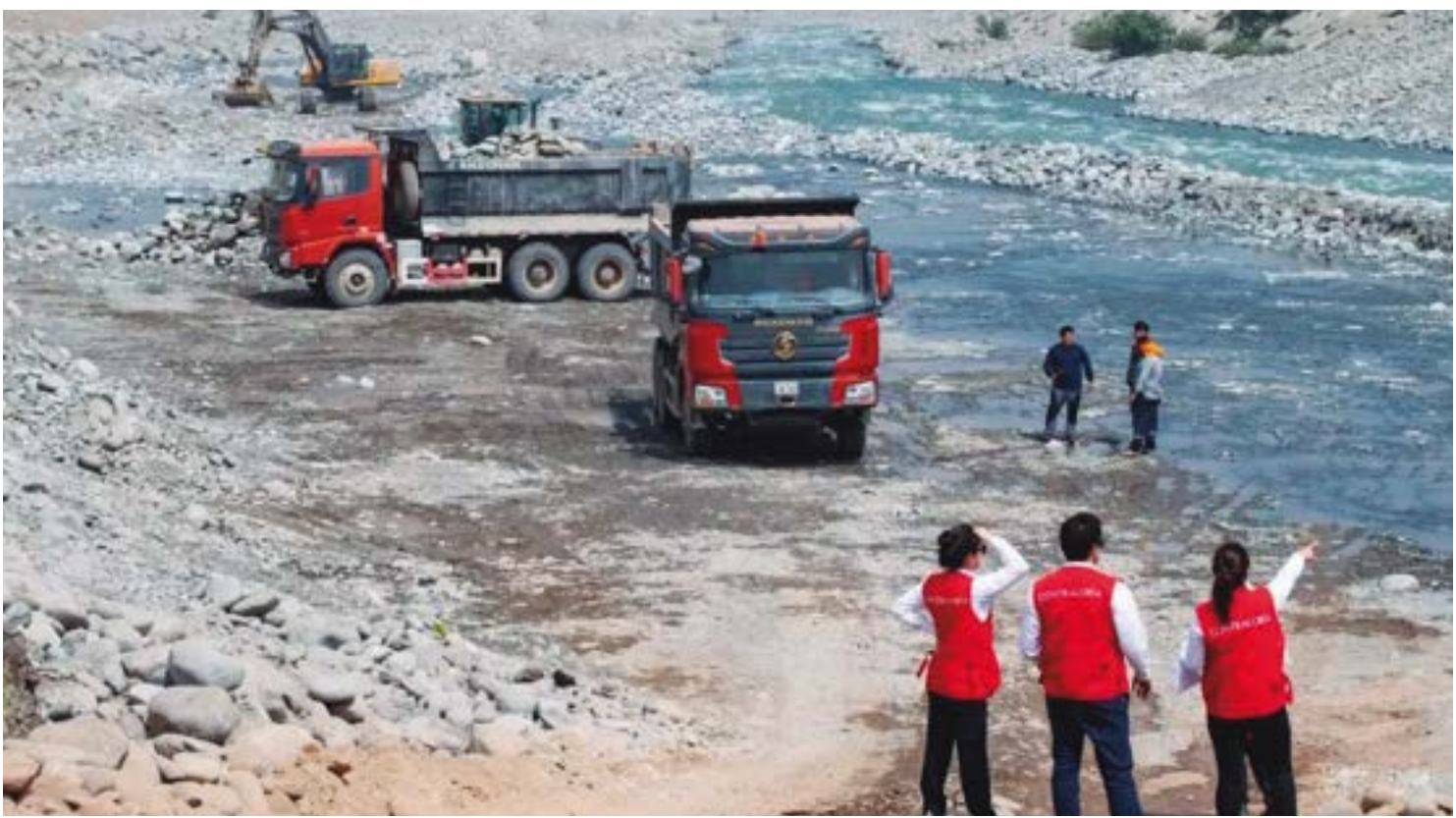
NO HAY TRABAJOS DE PREVENCIÓN.
