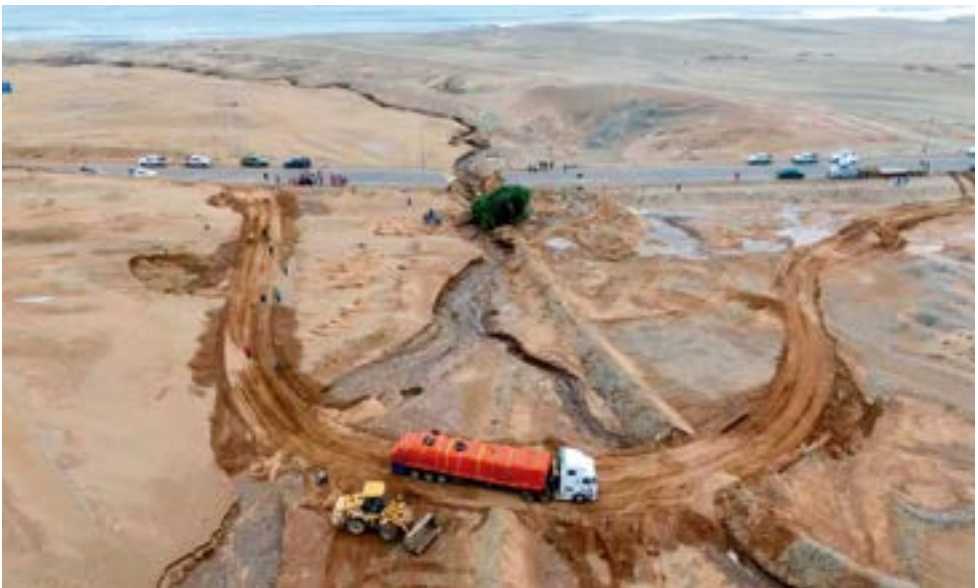
VÍA ESTÁ EXPUESTA.
