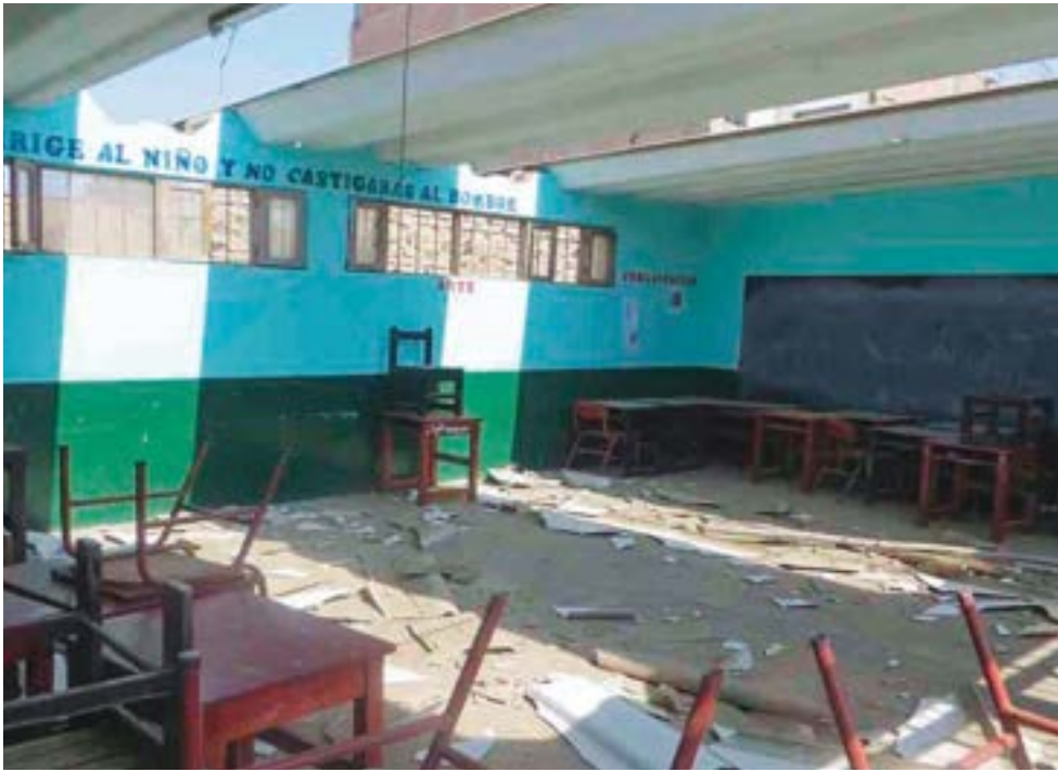
COLEGIOS ESTÁN EN MAL ESTADO.
