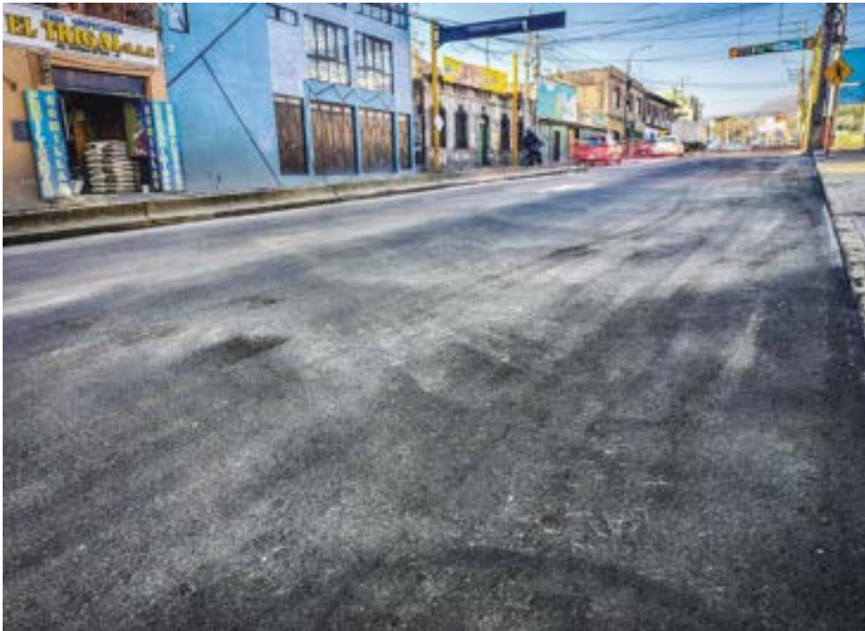
FALTA LA SEÑALIZACIÓN.
