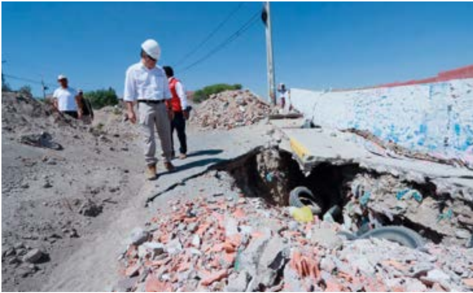
CONTRALOR RECORRIÓ ZONAS AFECTADAS.
