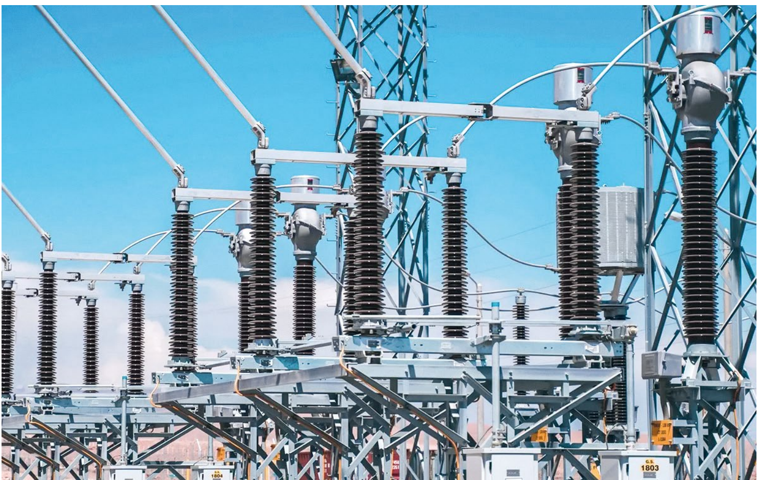
GENERACIÓN ELÉCTRICA CRECE.
